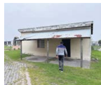
Die einfache Suppenküche in Thembaletu in Südafrika ist dringend renovierungsbedürftig.
